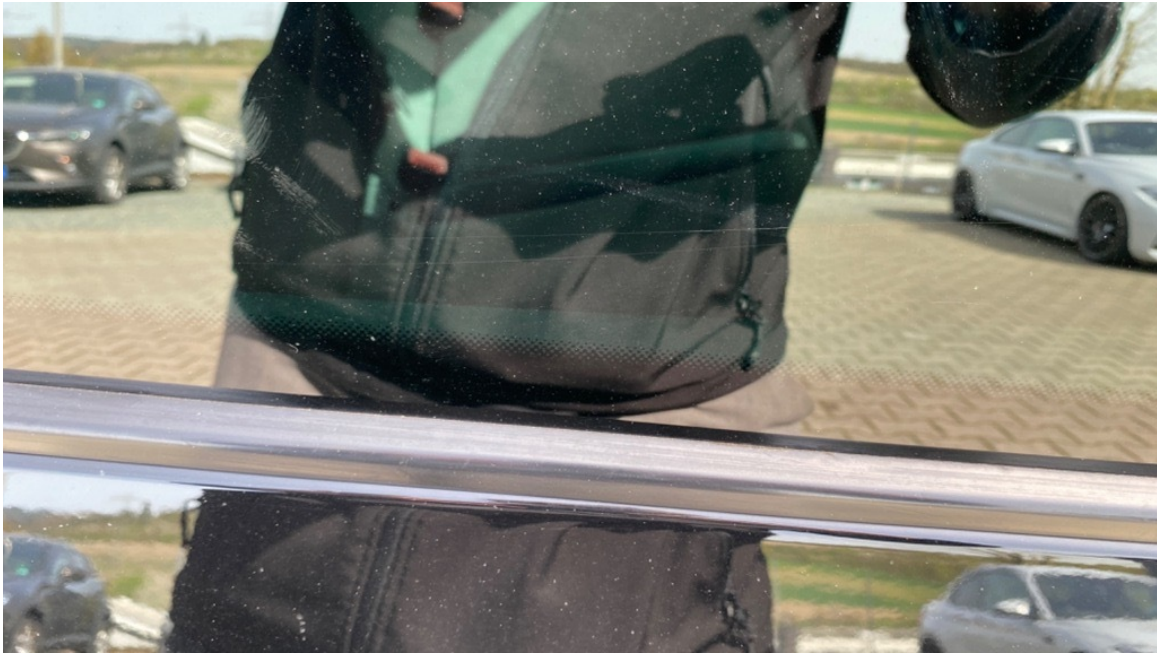
Bild 25 - Erneuerungsbedürftig - Abdichtung Fensterschacht aussen rechts
